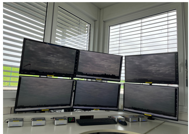
Überwachungswarte für das Live-Monitoring
